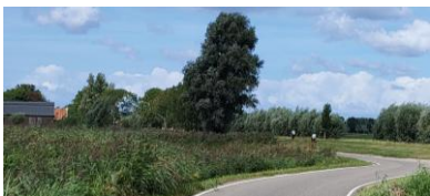
lokatie verzakking tijdens de aanleg Provinciale weg
